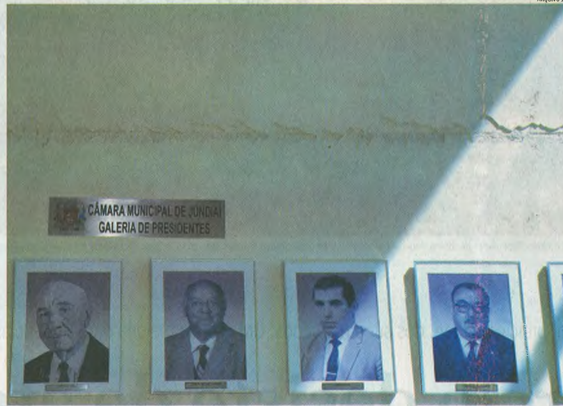
RACHADURA NA GALERIA Martinelli diz que infiltrações colocam em risco os frequentadores do prédio anexo: "às vezes chove lá dentro"
