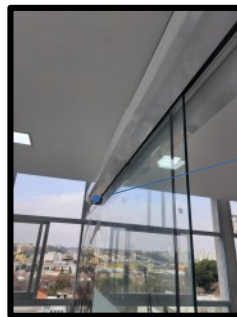
COPA: Divisória de vidro DETALHE: canaleta de encaixe do rodízio da porta de correr, distante 0,10m da divisória.
